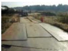
(c)鉄板（検知漏れ）
