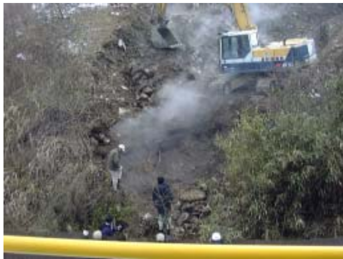
図 5-49：廃棄物不適正処分現場の様子
